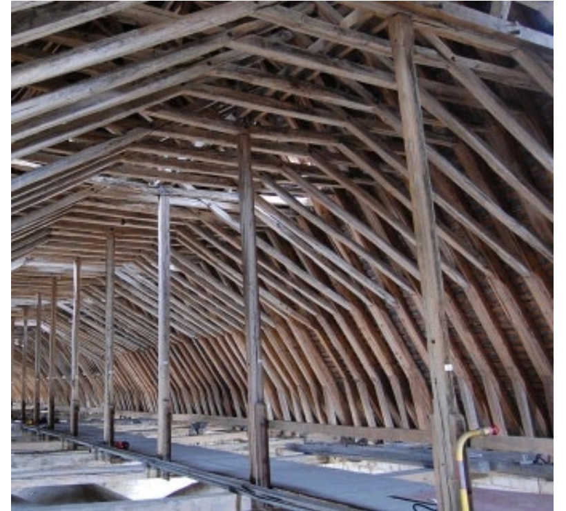
Charpente de la cathédrale de Bourges mise en œuvre en 1256-1258 avec des bois de brin longs et très fins, équarris à minima (cliché F. Epaud).
